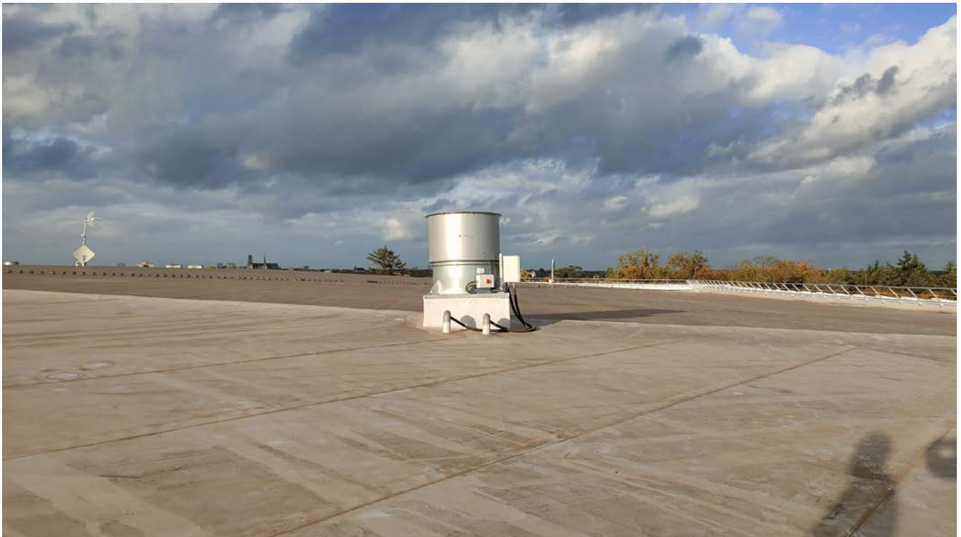
Figure 15 : vue de la partie nord-est du toit de la salle de sport
