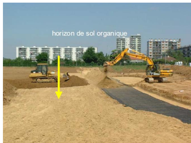
Illustration 5: Mise en place d'une géo-grille dans un parc paysager du Val de Marne
